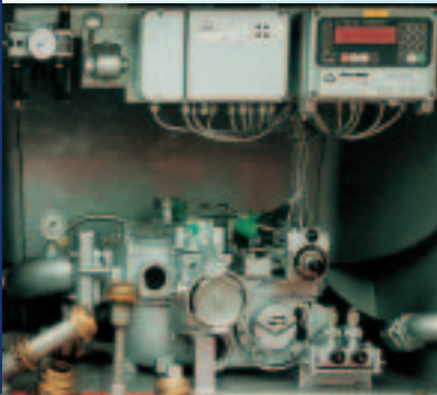
Armaturenschrank auf einem Straßentankwagen
